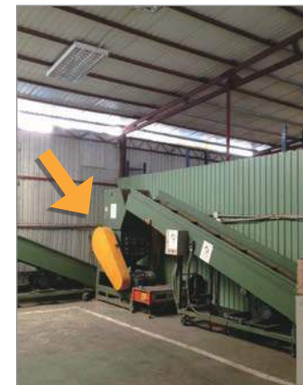
✅ 安裝固定式保護罩 隔開末端和滑輪
