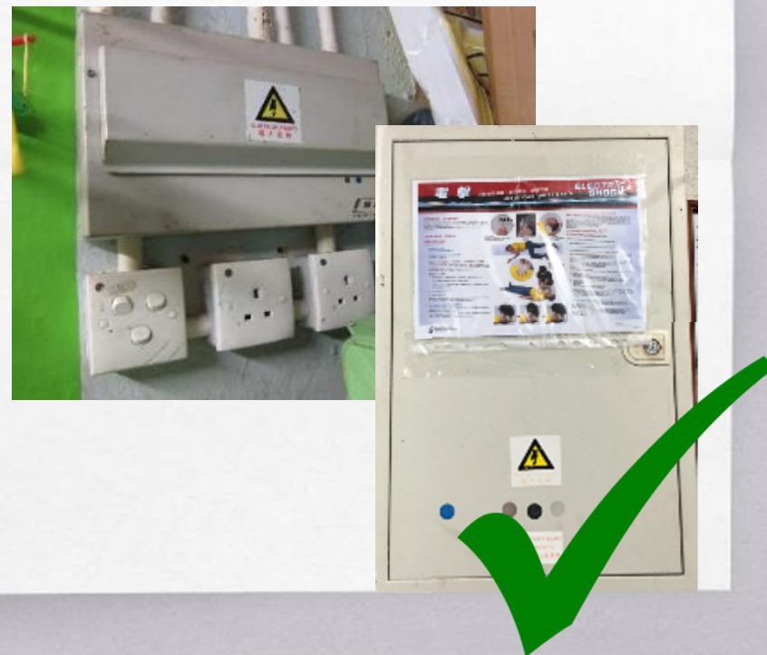
電箱貼有電擊告示及警告字句
