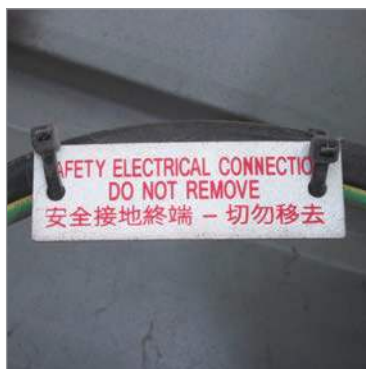
電源裝上合適接地
