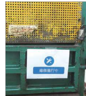
加上告示牌以示待修
