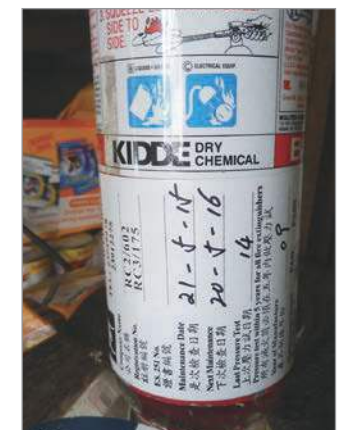
定期檢查滅火裝置
