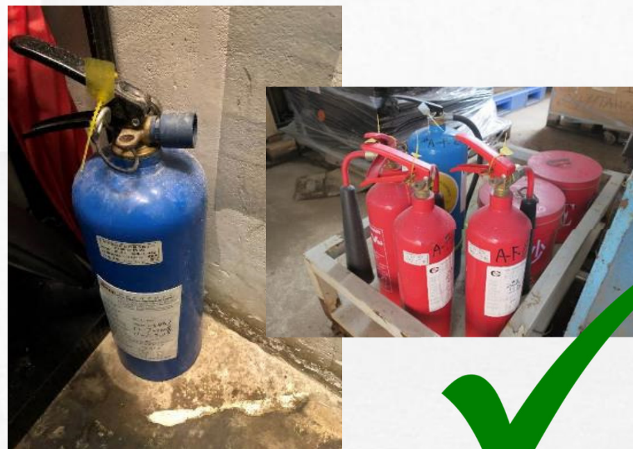
提供足夠及合適的滅火設備
