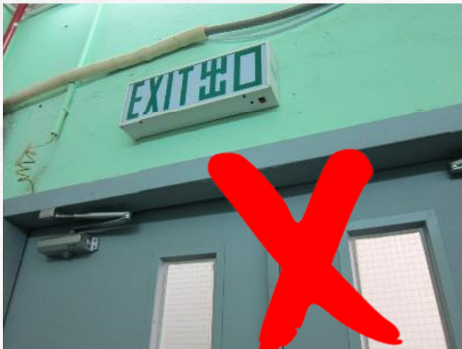
出口燈不能正常操作
