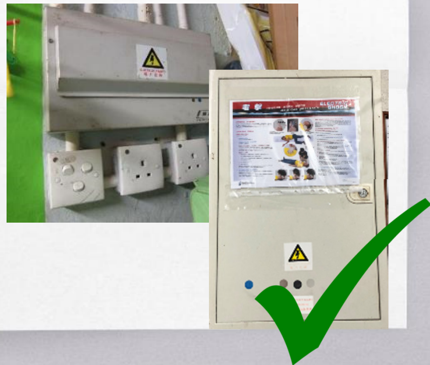
電箱貼有電擊告示及警告字句
